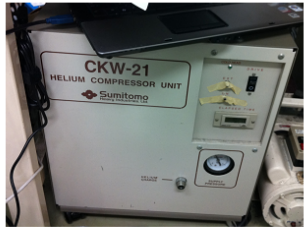
図 3.10. コンプレッサー
